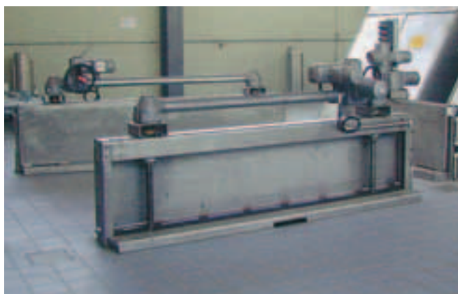
在污水处理厂的几个双阀杆闸阀
